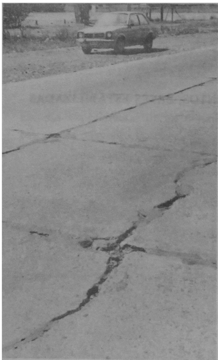
Destrucción generalizada de un sector de pavimento.
