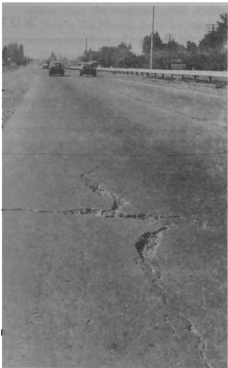
Estado de deterioro avanzado de un paño de pavimento.
